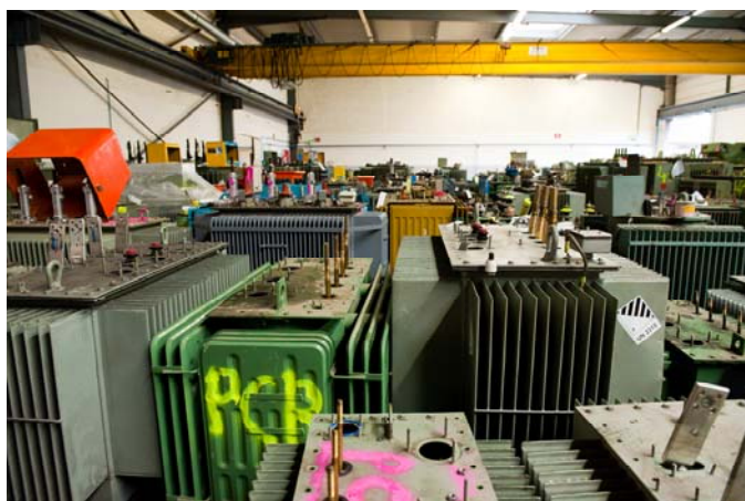
Figure 4 : zone de stockage des PCB en attente de traitement
